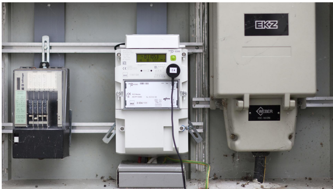
Einbau eines Smartmeters Quelle: picture alliance/KEYSTONE
